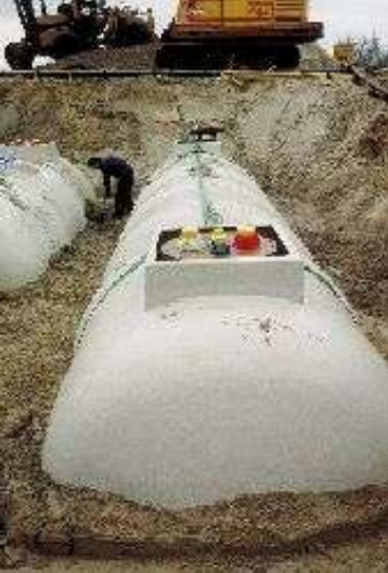
Tanque para almacenaje de combustible
