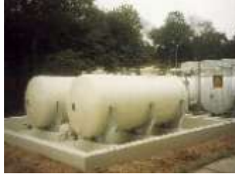
Tanques de agua potable
